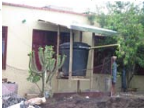
Tanque de recolección de aguas lluvias
