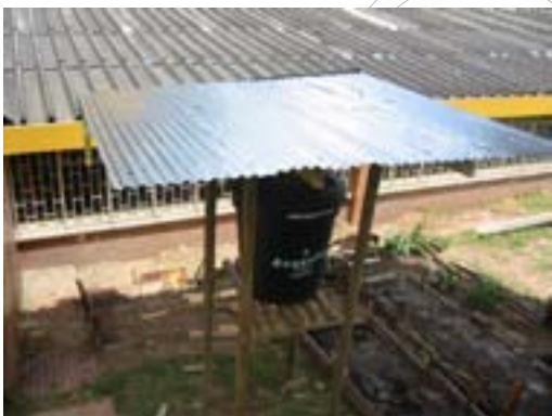
Unidad de captación de aguas lluvias
