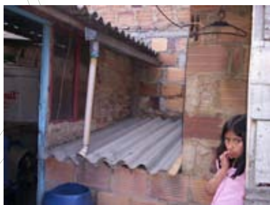
Conducción de lluvia
